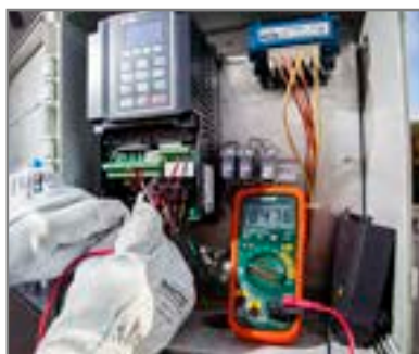
El filtro de paso bajo (LPF) garantiza mediciones precisas de voltaje de CA en una unidad de frecuencia variable.
